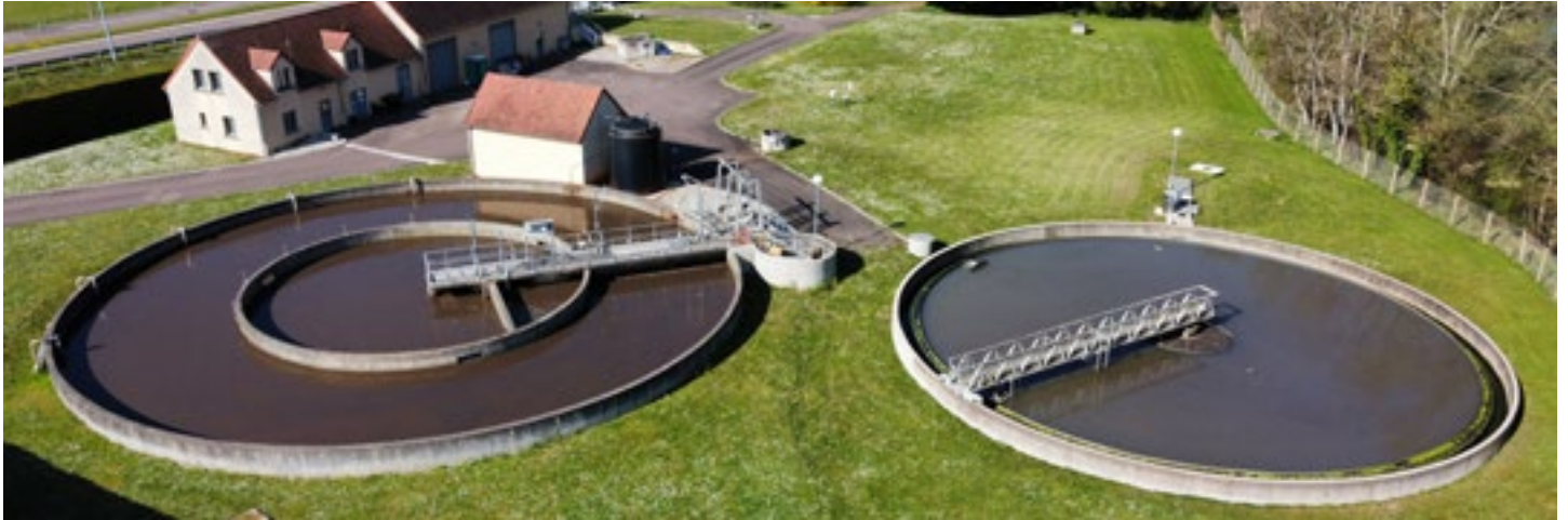
► La station d'épuration de Montbard.
